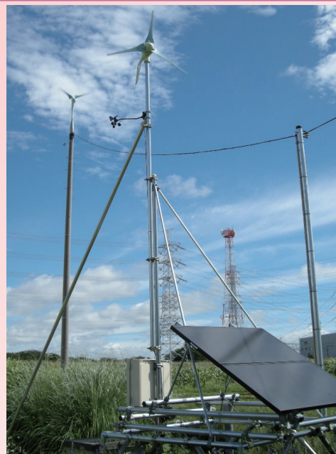
図1 所内に設置した太陽光パネル及び風力発電機
